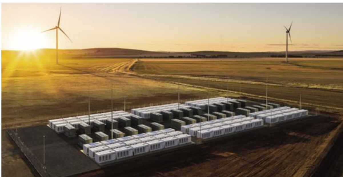
Figura 18 - Central de armazenamento de baterias de ião de lítio Hornsdale, Austrália, com 100 MW/129 MWh, para controlo de frequência.
