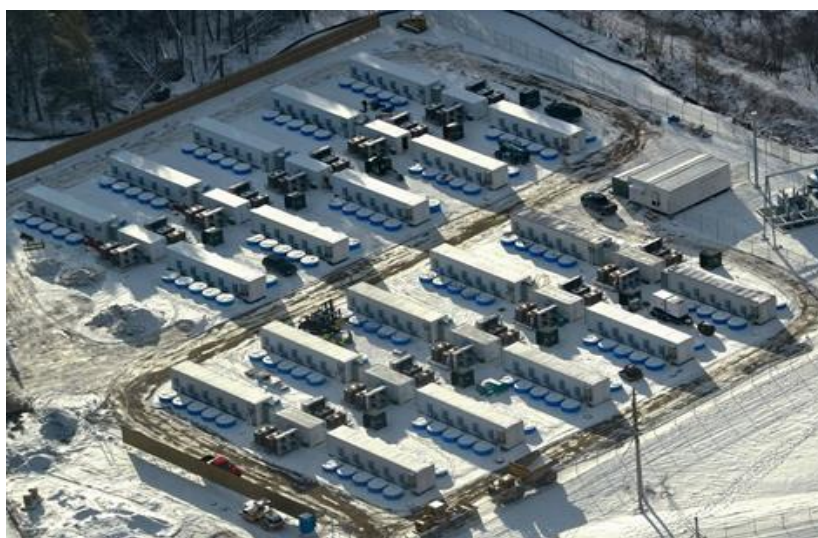
Figura 16 - Central de armazenamento de Beacon Power's com volantes de inércia em Stephentown, New York, com 2 MW (40 volantes de inércia de 500kW) e 5MWh para controlo de frequência.
